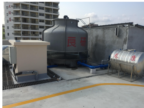
项目楼顶冷却塔
